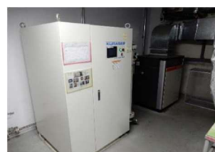
窒素ガス発生装置
