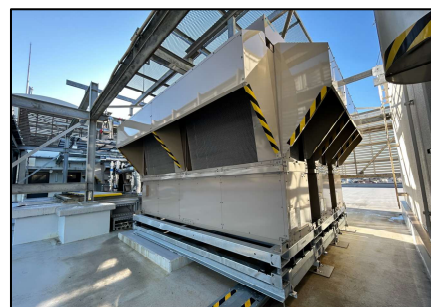
本社A棟チラー
